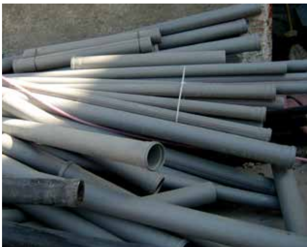
نحوه انبارش نادرست
